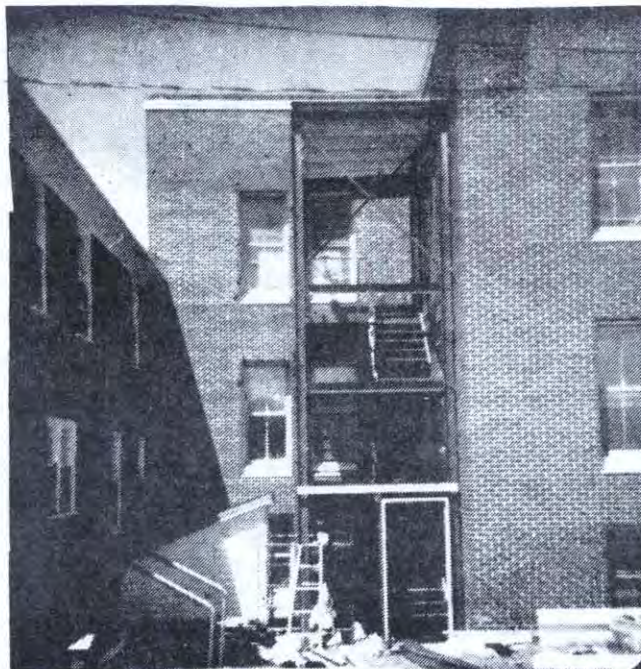
L'escalier de secours à l'hôpital du Sacré Coeur à Chéticamp en voie de construction avant la couverture d'asbeste. (photo Sr. M. A. Boudreau)
